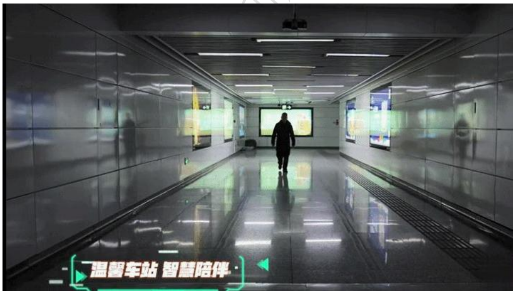
图 3 杭州地铁 2 号线车站智慧照明现场效果图
