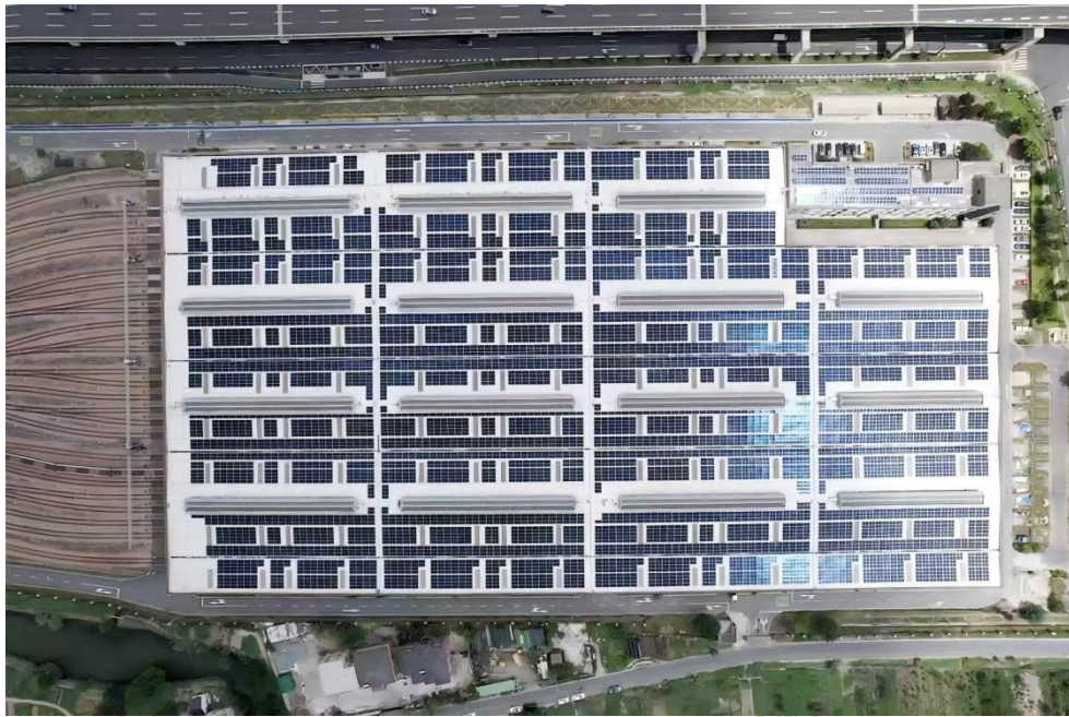
图 14 杭州地铁段场光伏屋面
